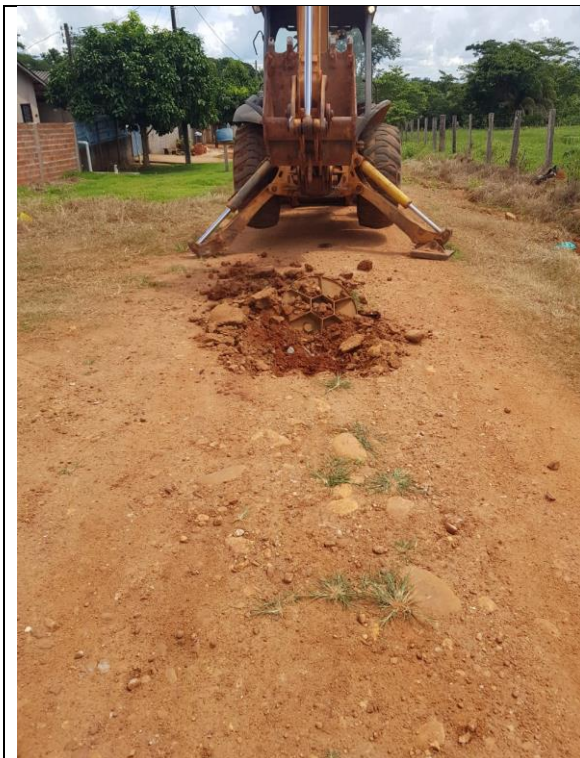
Figura 01: PV-25 obstruído por terra Fonte: Mamoré/2022.
