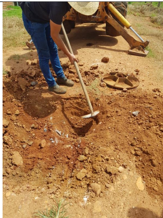
Figura 02: PV-25 obstruído por terra Fonte: Mamoré/2022.
